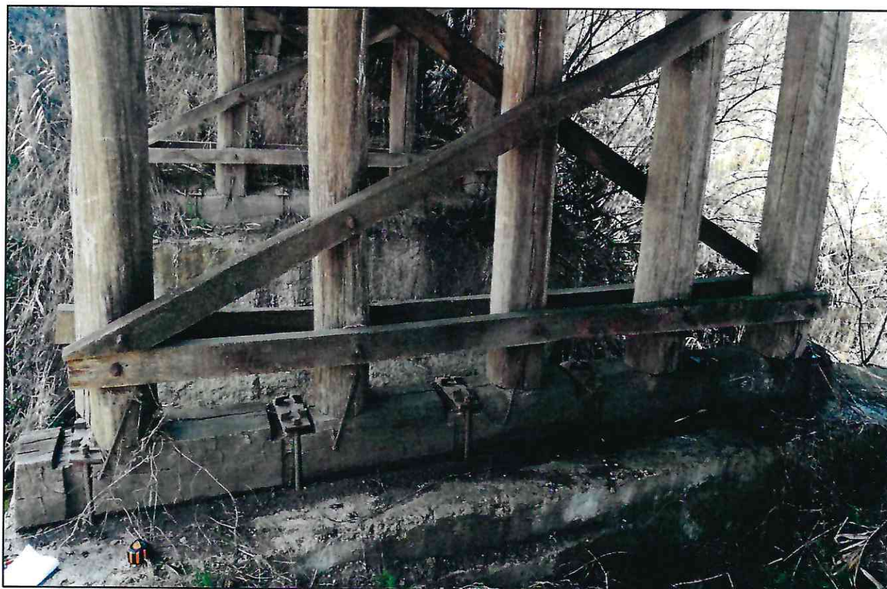
Foto nr. 7 - Degradarea pilotilor si a moazelor de contravântuire la palie
