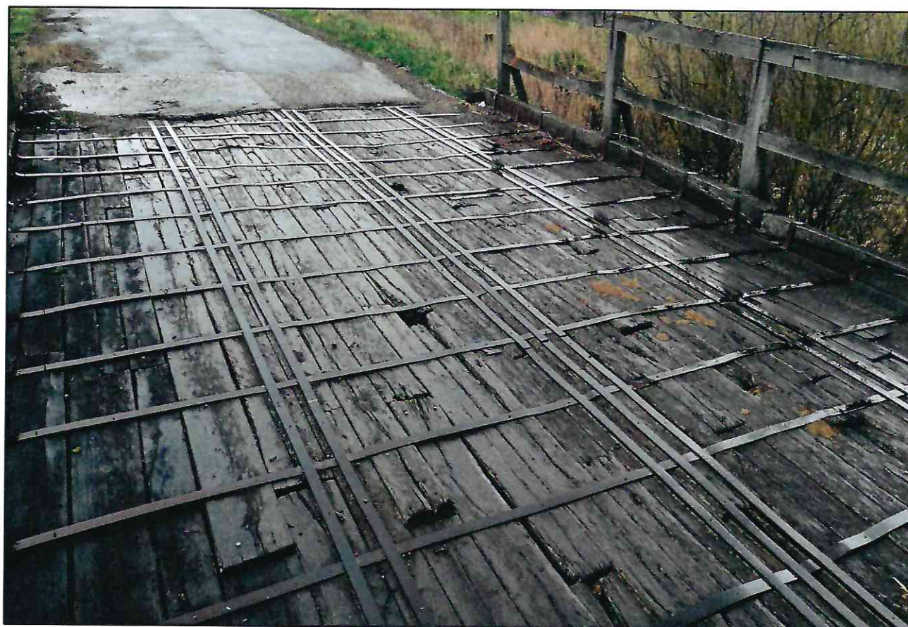
Foto. 3 – Degradarea parapetului pietonal de pod
