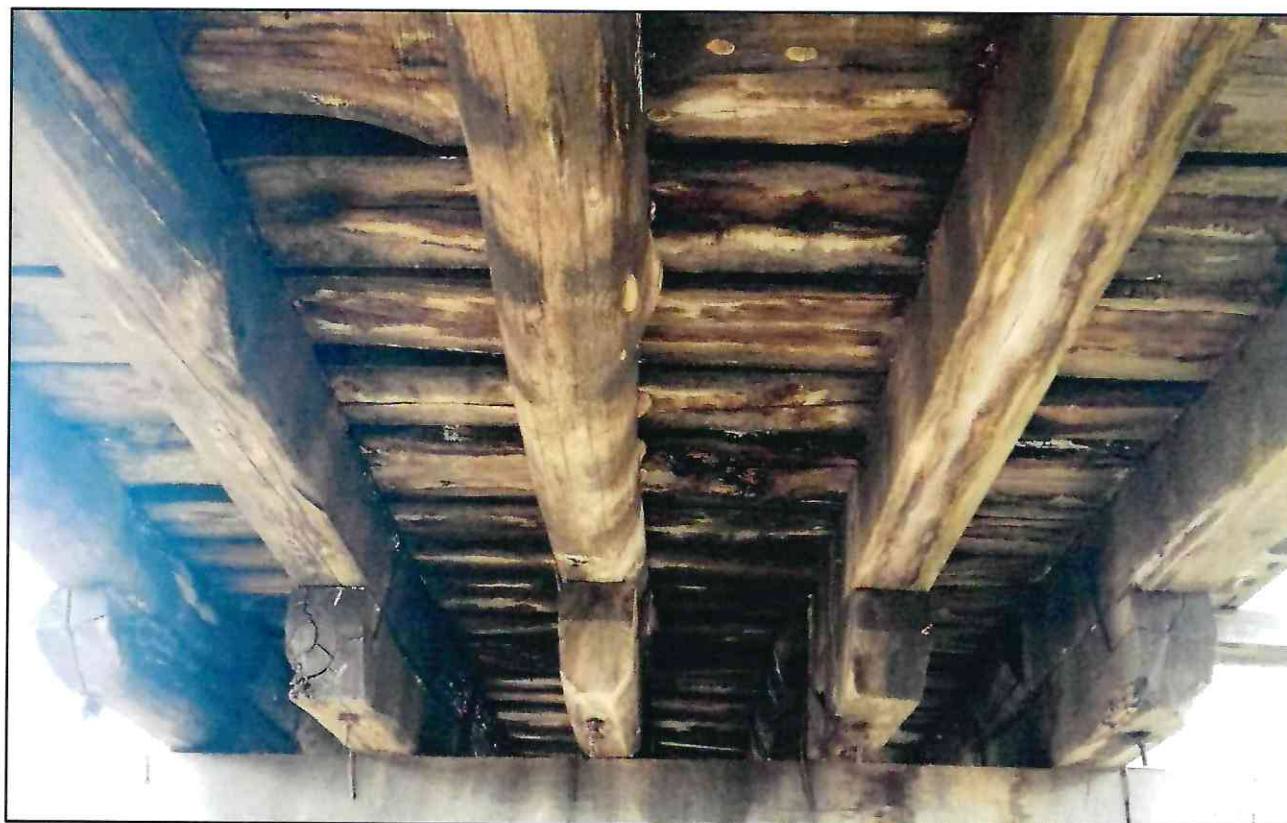
Foto nr. 5 - Degradarea urşilor din structura de rezistenta a suprastructurii podului
